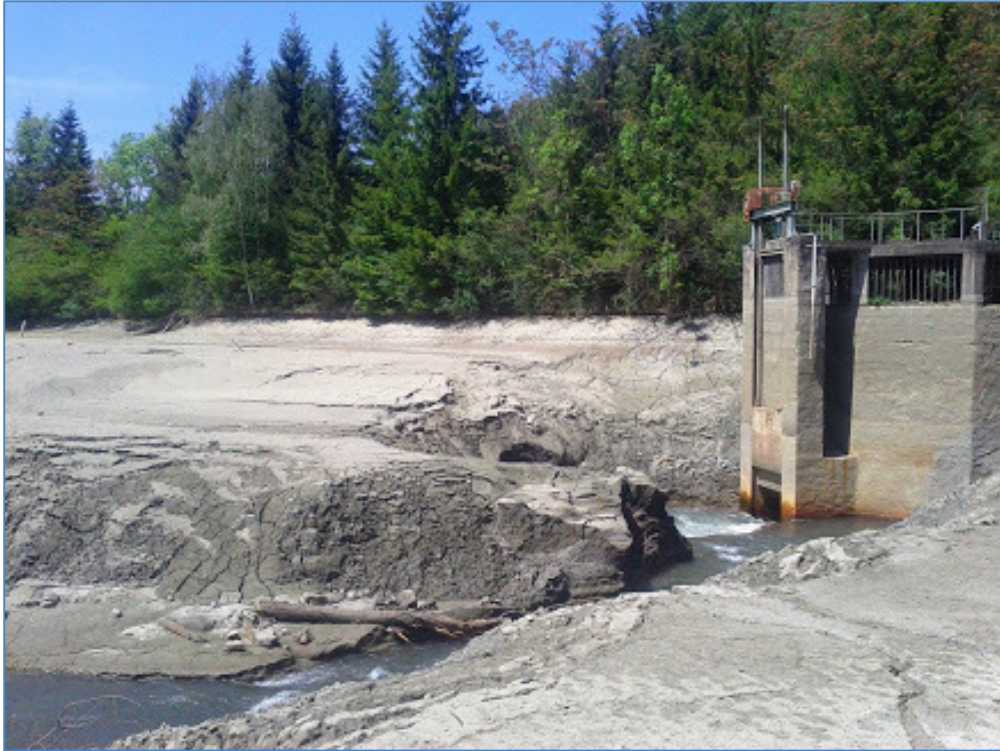
Abb. 10: Spülung eines Stauraumes über die Dauer von ca. 6 Monaten im Jahre 2012 (Foto © F. Bontadina). Er befindet sich 500 m vor der Mündung der Laming in die Mürz und damit knapp oberhalb jener Elektrofischungsstrecke (FKM 0,4), in der von Woschitz (2015) das Verschwinden der Äsche und ein Biomasserückgang von im Jahre 2000 128,4 kg/ha auf 2,6 kg / ha im Jahre 2013, als auf ca. 2% des Vorbestandes, konstatiert worden ist.
