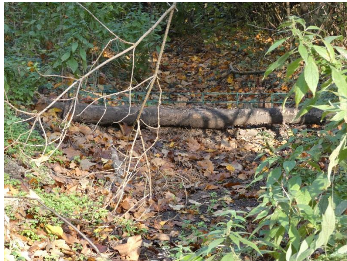
Abb. 22: Die derzeit durch Erde und Laub verlegte Wasserrinne aus dem Prießnitztal als Zulauf von KG2.
