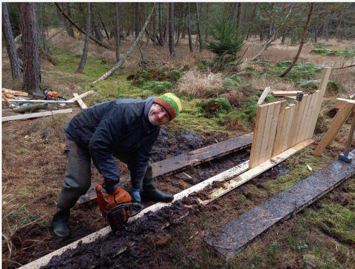
Einbau von Holzsperrn zur hydrologischen Sanierung des Bummermoos. Winter 2020. Foto J. Brocks
