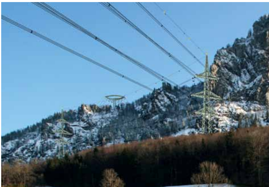
380-kV-Leitung im Bereich des Nocksteins. Visualisierung Robert Marschallinger
