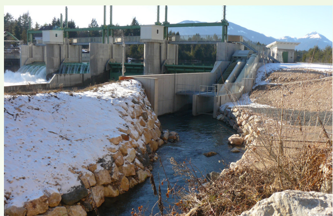
Der neu gestaltete Damm der Kraftwerksanlage in Oberschütt, mit der Fischaufstiegshilfe (rechts), das ist eine rotierende Archimedische Spindel, die die anstehenden Wanderfische erfolgreich nach oben befördern soll.
